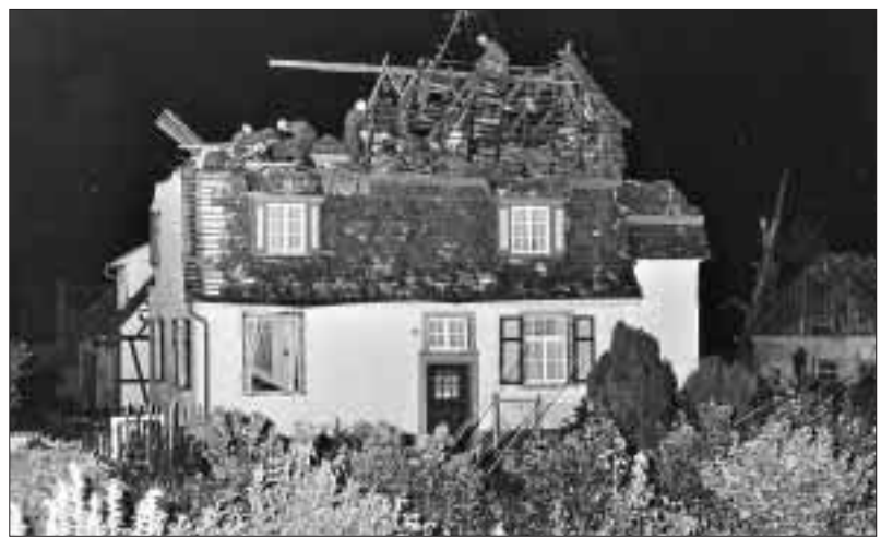
Auch in Neubärenthal hat der Tornado noch Dächer abgedeckt.
